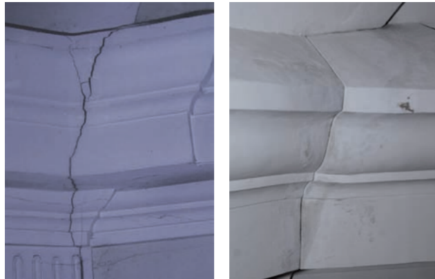
Chor, Rissverlauf im Gurtbogen
