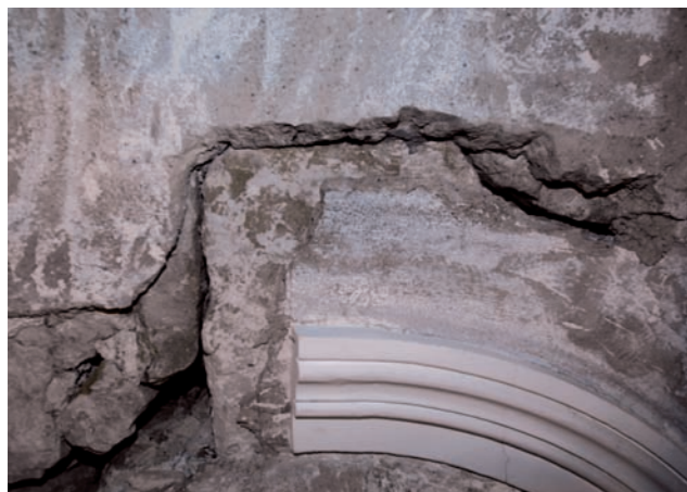
Riss an der Südwand zum Turm
